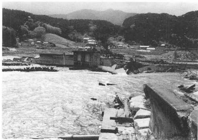
壊滅した越喜来浦浜海岸の防潮堤と防風林
